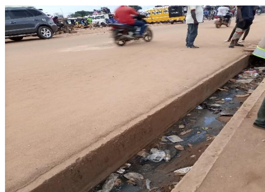
Photo 14 : Caniveau ensablé au niveau de la voie à élargir à Mankono
