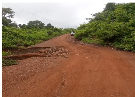
Photo 12 : Voie en terre sur la route de Kongasso, présentant les effets de l'érosion
