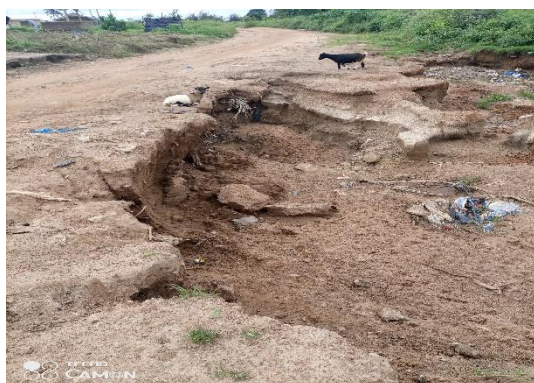
Photo 9 : Effet de l’érosion sur le tronçon au niveau du village Banoufla 2 à Zuénoula (Source : BNETD, 2022)
