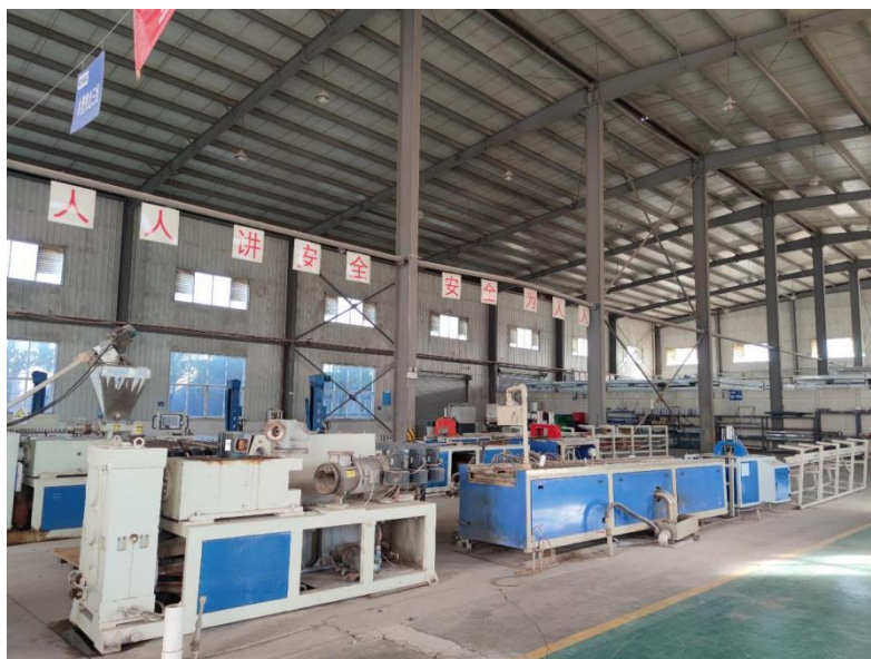
图 9 废弃物回收生产线（云南昆船环保技术有限公司）
