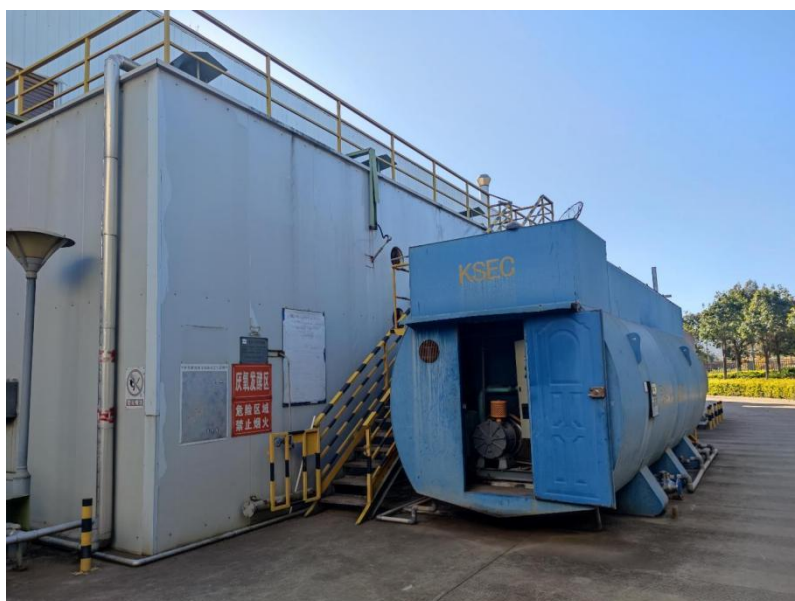
图 7 生活垃圾渗滤液处理装置
