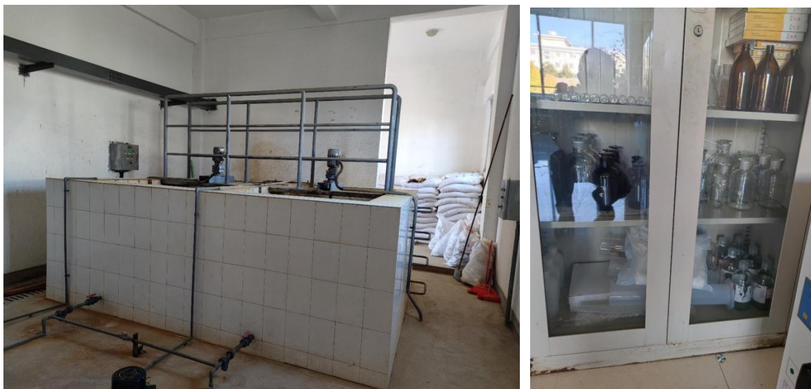
图 2 污水处理系统的投药装置和化学品存放
