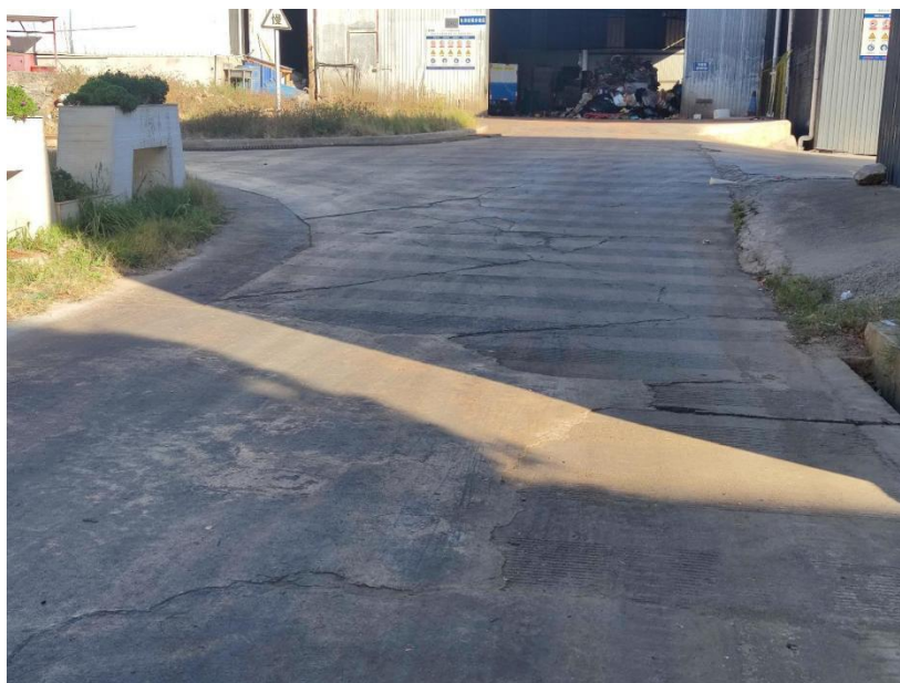
图 6 生活垃圾暂存区混凝土地面裂缝
